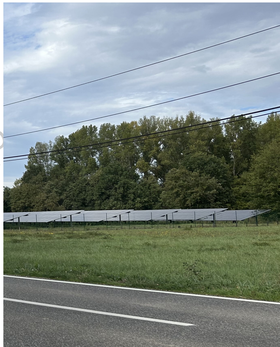
Parc photovoltaïque au sol © Karthéo 2022
