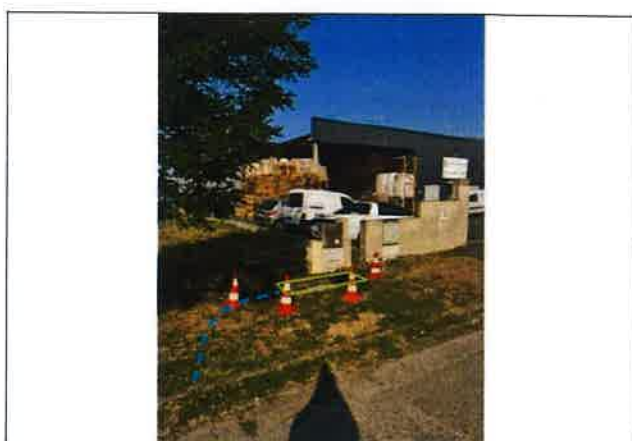
Percution de la chambre FREE MOBILE existante
